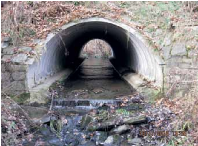
Abb. 32: BRÜCKE MIT BERMEN, ABER FEHLENDEM UFERANSCHLUSS (FOTO E. AYBOGA)
