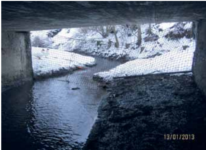
Abb. 44: NETZABSPERRUNG UNTERHALB EINER BRÜCKE, WELCHE DIE PASSAGE KOMPLETT VERHINDERT (FOTO M. SCHMALZ)
