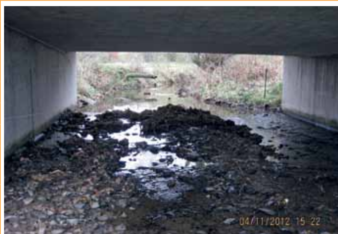
ANGESCHWEMMTES GERÖLL UNTER DER BRÜCKE (FOTO M. SCHMALZ)
