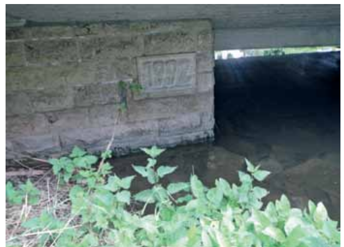
ABB. 31: IN DAS GEWÄSSER HINEINRAGENDES WIDERLAGER EINER BRÜCKE, HIER WÄRE EINE UMFANGREICHE ANSCHÜTTUNG NOTWENDIG (FOTO E. AYBOGA)
