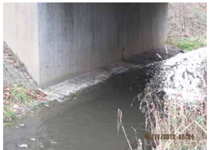
Abb. 25: Mittlere Gefährdung: Sehr flache Berme, die bei Mittelwasser überschwemmt wird (Foto M. Schmalz)
