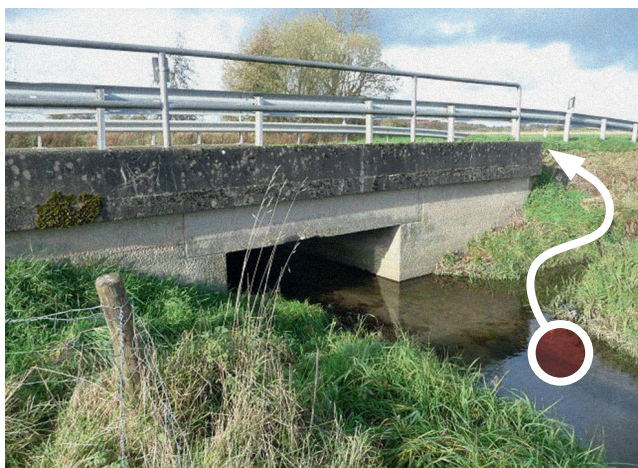
Ein direkt vor einer Brücke abzweigender Entwässerungsgraben kann zum Ausstieg verleiten, zumal hier der Gewässerlauf breiter ist als der Durchlass. Letzterer ist zudem schmal im Vergleich zur Tiefe, was sich bei Hochwasser noch verstärkt.
